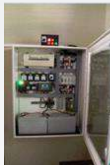
Inverter & Solar Charge Controller pada PLTS
